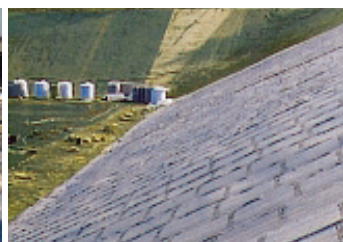
Enkadrain® anvendt i et deponi.
